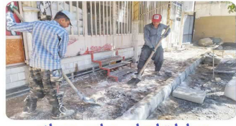
عملیات اجرایی پیاده رو سازی کوچه شهید محسن جعفری بلوار امام خمینی (ره)
