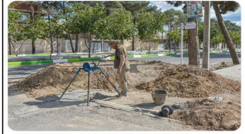
ادامه عملیات حفر چاه جذبی جهت دفع آب‌های سطحی بلوار ابوذر، بن بست یاسمن
